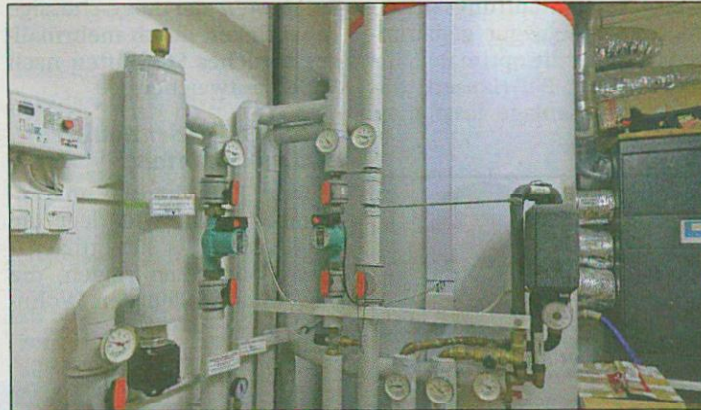
Herzstück: Die Technikzentrale des Hauses vereint die Wärmepumpe, Lüftungsanlage und einen Wärmespeicher.
